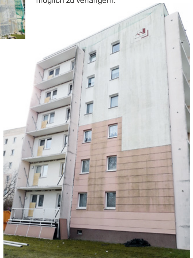
Bruno-Beye-Ring 45 während des Abbauprozesses der alten Balkone, die durch größere ersetzt werden sollen.
